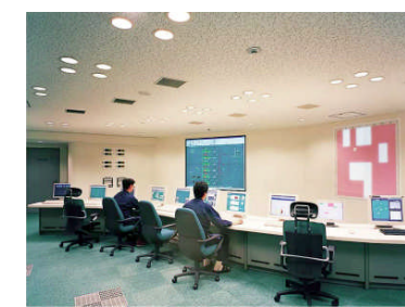
発電施設の中央コントロール室
