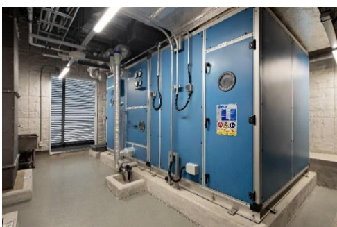
高性能空調フィルターを実装した空調機
