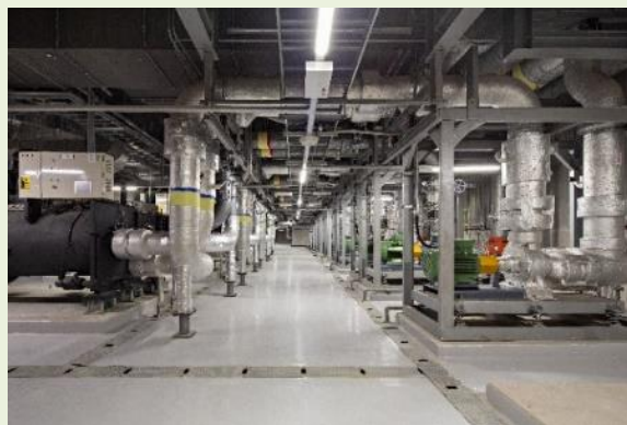
省エネ性能の高い熱源設備
