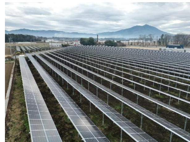
森ビル筑西市桑山営農型太陽光発電所
