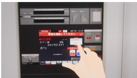
①火災報知器の警報の停止
