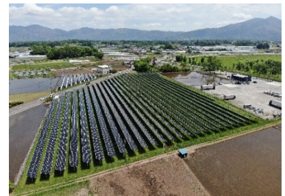
筑西市桑山営農型太陽光発電所
