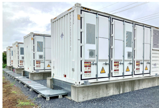
系統用蓄電所(埼玉県深谷市)
