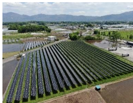
営農型太陽光発電所(茨城県筑西市の例)
