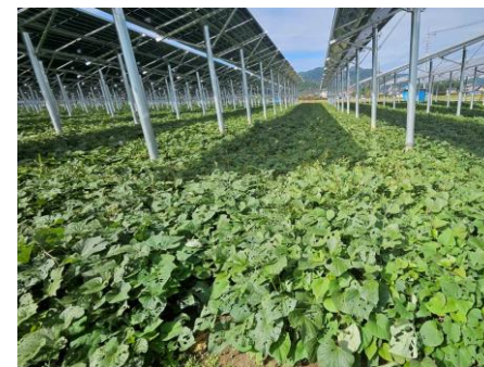
森ビル栃木市宮町営農型太陽光発電所
